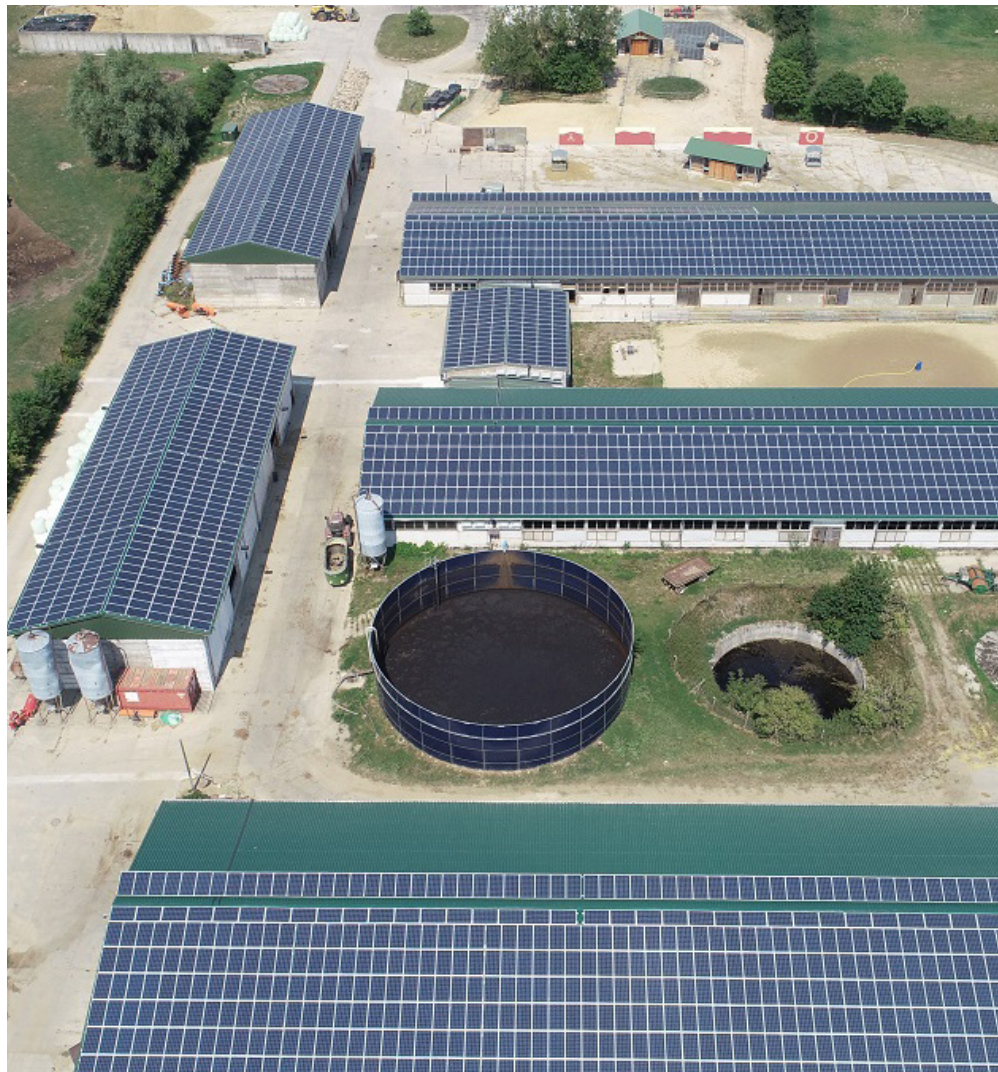
Retschow – Anlageobjekt ZUKUNFTSENERGIE DEUTSCHLAND 4
