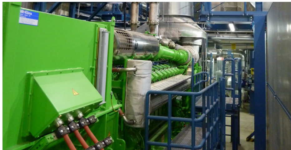
BHKW Ulm/Senden – Anlageobjekt ZUKUNFTSENERGIE DEUTSCHLAND 4
